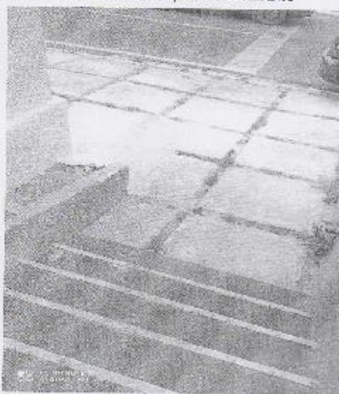
(CALÇADA NÃO EXECUTADA)
