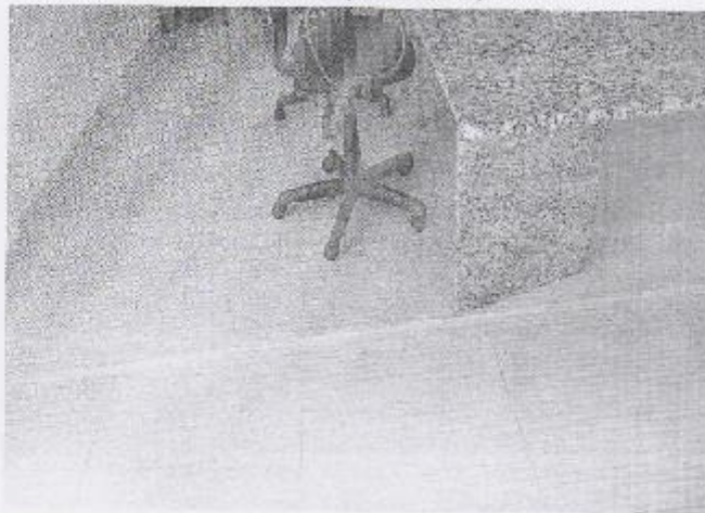
(REVESTIMENTO EM PORCELANATO DESNIVELADO DEVIDO NÃO TER FEITO NIVELAMENTO DO CONTRAPISO)
